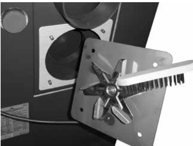
Muster – die Reinigung und die Kontrolle der Schaufel bei Saugzuventilator
