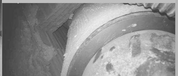
Schlechter Anschluss des Rauchzugs und keine Dehnung des Zuglochs möglich
