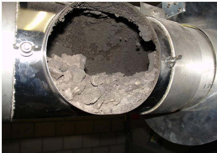
Bild 14) Blick auf ein T-Stück bei ausgebautem Abscheidereinsatz mit deutlich zu hoher Beladung. Hier wurde die Reinigung über längere Zeit vernachlässigt.
