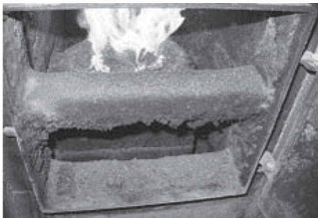
Abb. 13 Sehr verschmutzte Brennkammer des Kessels.
