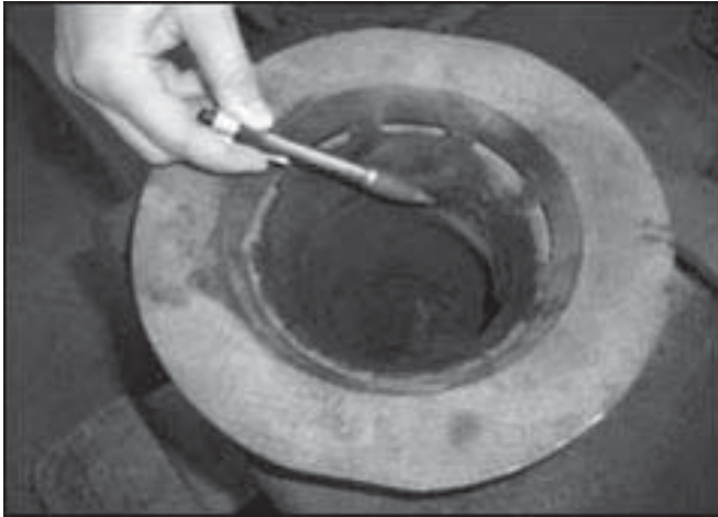
Abb. 10 Entfernung der Ablagerungen aus dem Knie des Brenners
