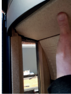
2: Die obere Rauchumlenkung wird vorsichtig über die beiden Vermiculitepfosten im Kaminofen gehoben.
