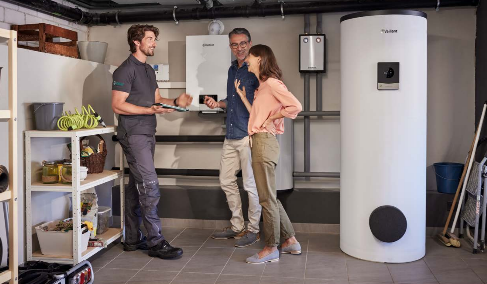
Hybridsystem aus Gas-Brennwertgerät, Puffer- und Warmwasserspeicher sowie ...
