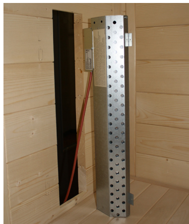
rys. 2: Pozycja skrzynki przyłączowej
