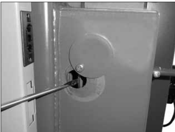
Die Kontrolle und Reinigung der Öffnung bei der Primär-sekundärluft (Einstellhebel)
